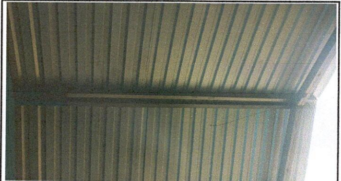
Foto 2: las condiciones en que se encuentran las laminas y capote en esta parte del establecimiento por las condiciones admosfericas, siendo necesario el cambio por nuevas.
