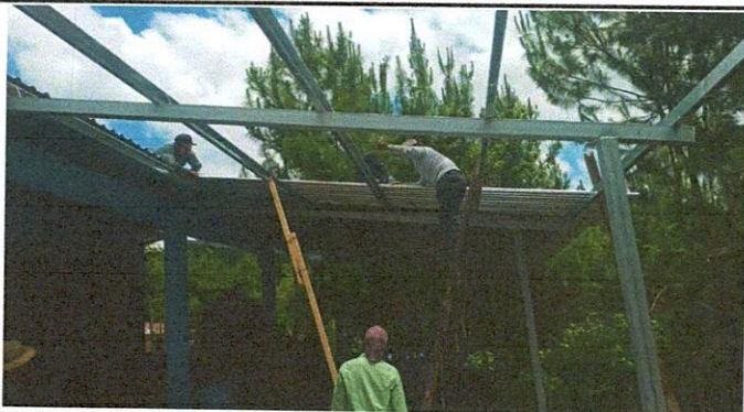
Foto 3: la estructura metalica en el corredor de la escuela no reúne las condiciones de seguridad para los alumnos.
