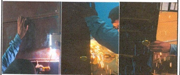
Foto 4: las chapas de primero primaria, cuarto y la bodega estan en muy malas codiciones siendo muy necesario reemplazarlos en nuevos.
